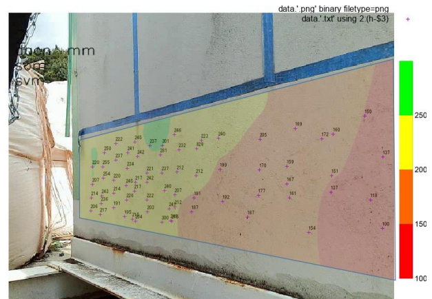
図-22 斜めの剥離欠陥 推定部材厚さ(mm)
