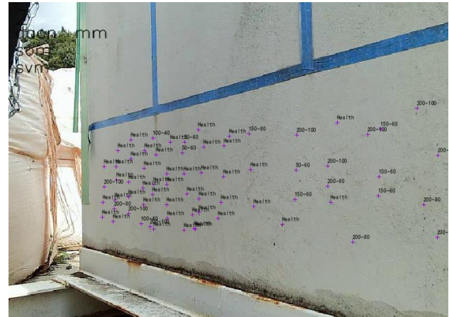
図-23 斜めの剥離欠陥 SOM
