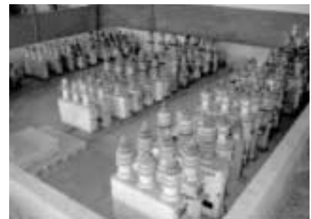
高圧コンデンサーの保管状況
