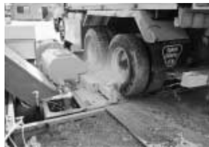
タイヤ洗浄装置/岐阜県 小鳥トンネル作業所
