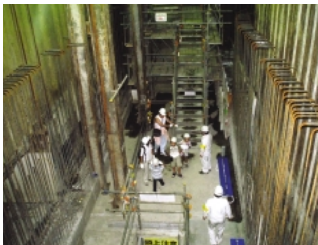
鉄筋や鉄骨が剥き出しになっている地下空間
