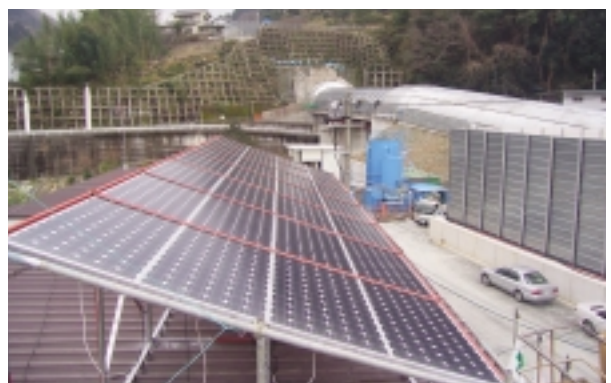
作業所事務所の屋根に設置した「どこでもソーラー」
