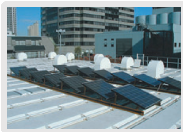
No.3:防音ハウス屋上に設置したどこでもソーラー
