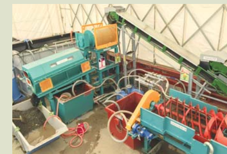
処理プラント内部
